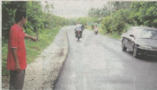
Ramlan menunjukkan keadaan jalan yang diturap dan dilebarkan tanpa mengikut spesifikasi ditetapkan.
